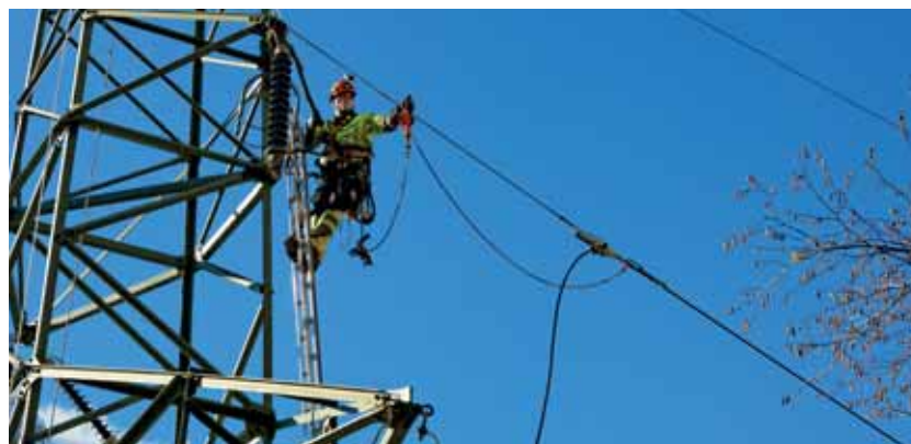
Bild: ewl energie wasser luzern
