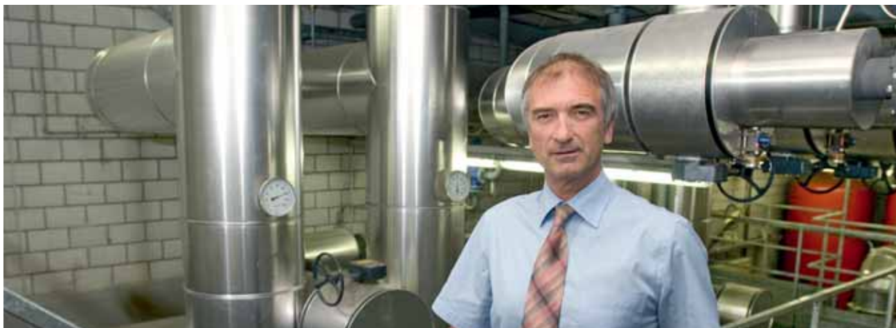
Abfälle aus der Zentralschweiz werden heute aus Kapazitätsgründen in der Region Zürich und im Aargau verbrannt. Eine neue, grössere Anlage im Raum Luzern könnte eine Menge Transportkilometer einsparen und die in den Abfällen enthaltene Energie effizient nutzen (im Bild: Jürg Meyer, Direktor der KVA Luzern).
