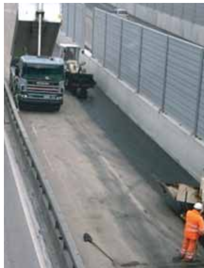
Die Bautätigkeit im Kanton Luzern (im Bild: Arbeiten am Anschluss Emmen Süd) wurde intensiviert. Foto: Verkehr und Infrastruktur, vif
